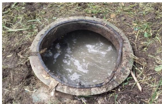
Figura 6 – Caracterização das instalações ETE Provisória, após a manutenção realizada.
