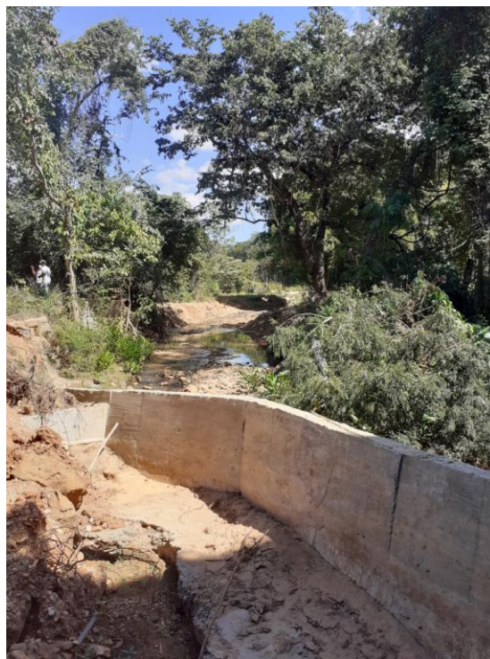
Imagem 2 - Contenção destruída pela chuva, no trecho da servidão a ser redirecionado. Fonte: Arquivo DMA
