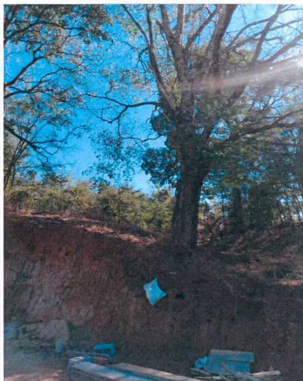
Foto 05: Destaque para raízes expostas devido o corte no terreno.
