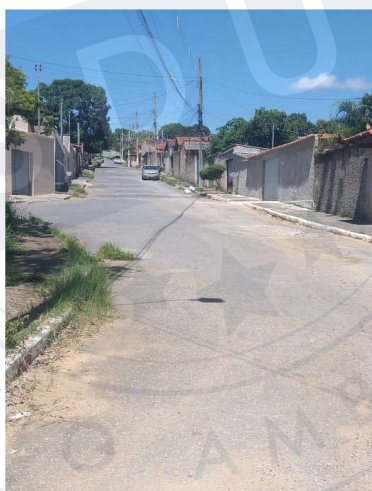
Imagem 3. Demonstração das características da via a qual se solicita recapeamento (Rua Elias Matoso). Fonte: Arquivo SDU
