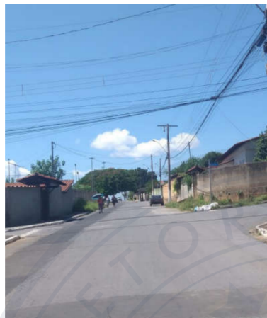
Imagem 1. Demonstração das características da via a qual se solicita recapeamento (Rua Ismar Francisco Santos). Fonte: Arquivo SDU
