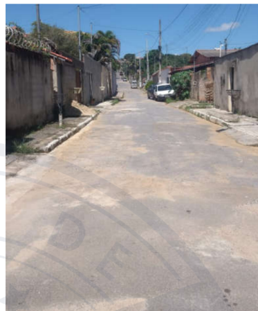
Imagem 2. Demonstração das características da via a qual se solicita recapeamento (Rua Ismael do Carmo Madeira). Fonte: Arquivo SDU
